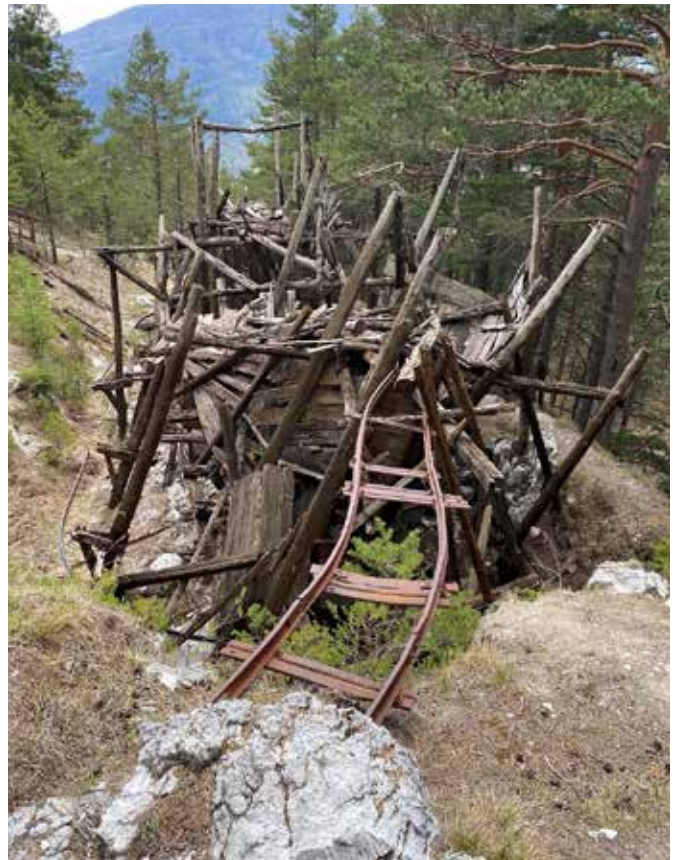
Struttura ormai in stato fatiscente all'imbocco delle gallerie delle miniere. Si possono notare le rotaie su cui giungevano i carrelli dalla miniera
